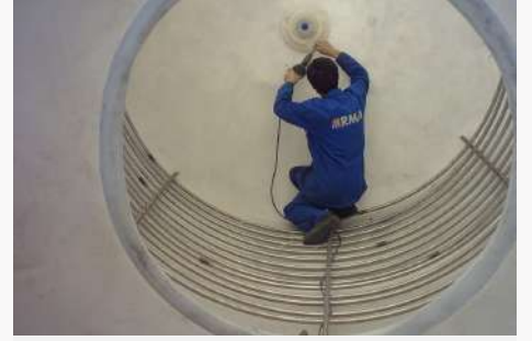
Isıtıcı Tanklar - Heating Tanks
