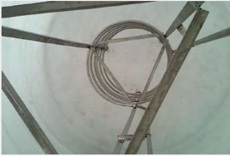
Isıtıcı Tanklar - Heating Tanks
