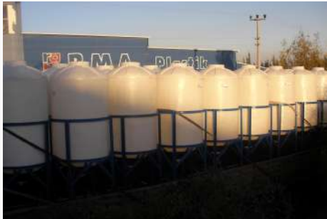
Turşu Tankı - Brine Tanks
