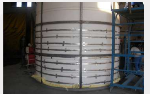
Isıtıcı Tanklar - Heating Tanks
